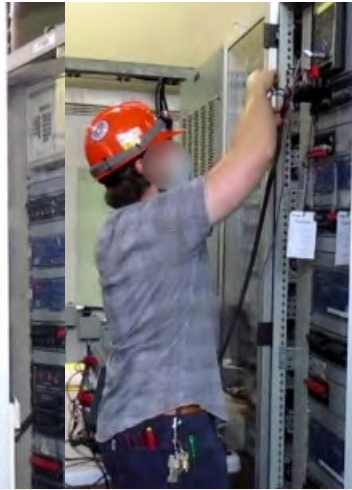
Branchement d'équipement de test
