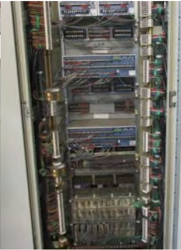
Armorie à relais (câblage manuel)
